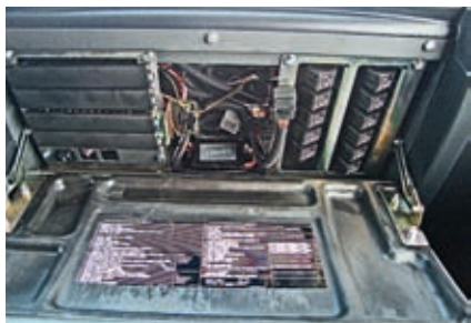
Монтажный блок установлен на панели. Обилие релюшек – очень полезно
